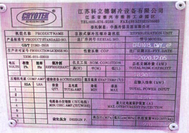
中温冷凝机组铭牌
