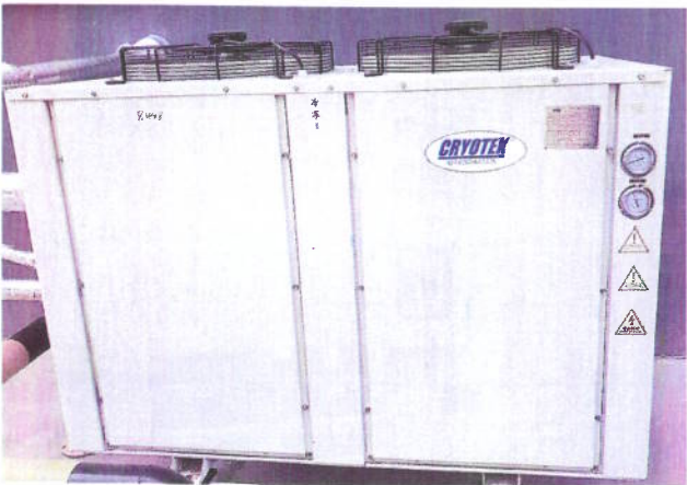
低温冷凝机组外观（R507A 与 R448A 制冷机组相同）
